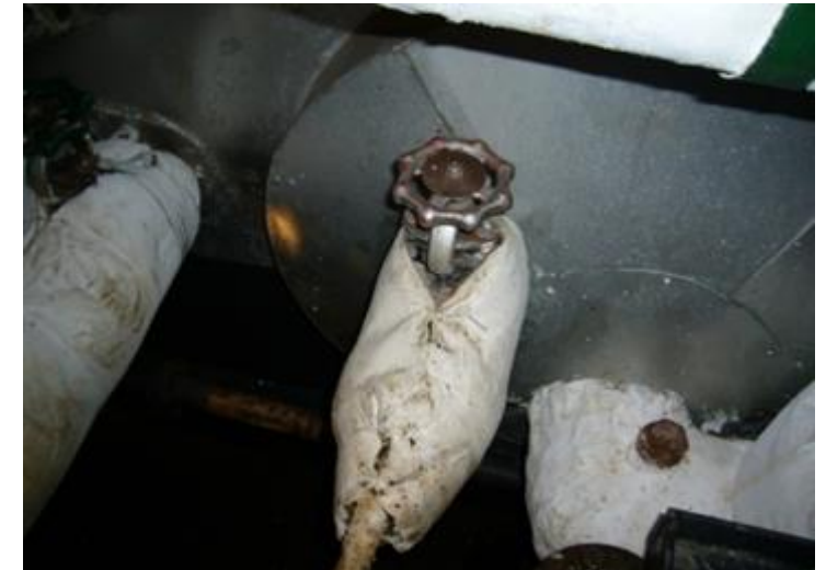
蒸気弁に使用のアスベスト布団
