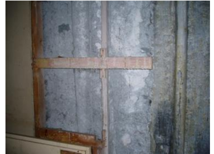
居住区壁裏の吹き付けアスベスト材
