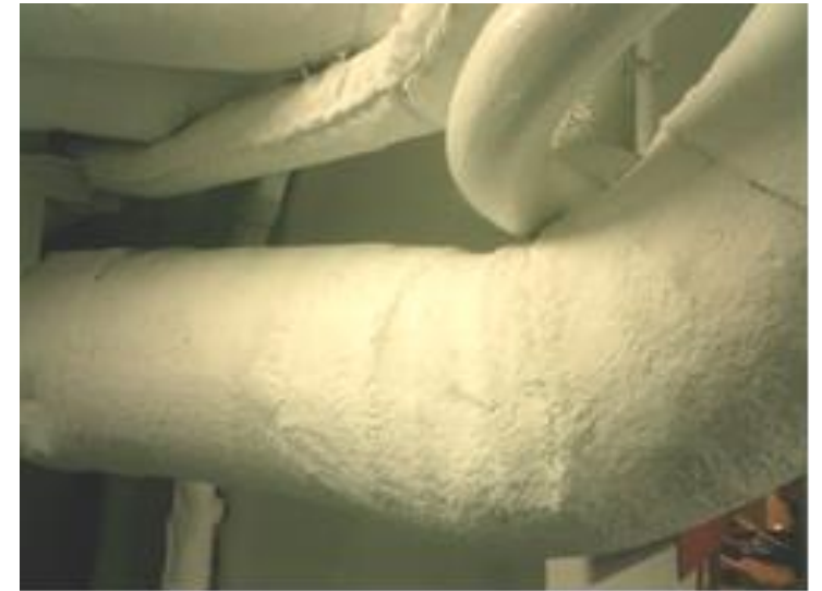
アスベストクロスを巻き付けた 蒸気配管
