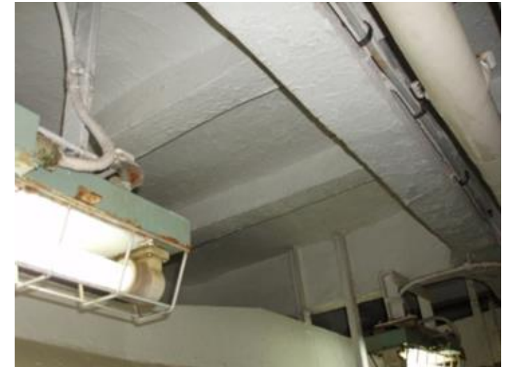
天井に吹き付けられた結露防止 アスベスト材
