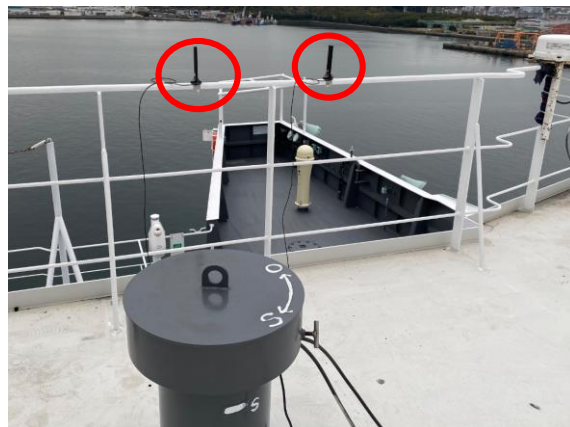
コンパスブリッジのアンテナ設置状況
