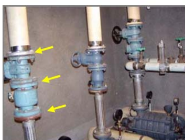
パルプ継ぎ手などへのパッキング・ガスケット (継ぎ目に挟まっていますので写真では見え ていません)
