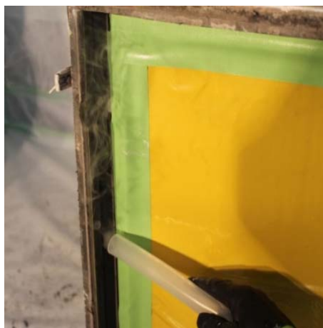
参考図3.25 HEPAフィルター周辺部分
