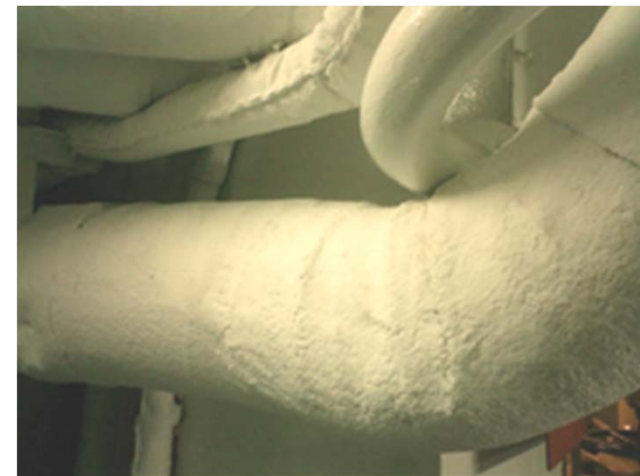
アスベストクロスを巻き付けた 蒸気配管
