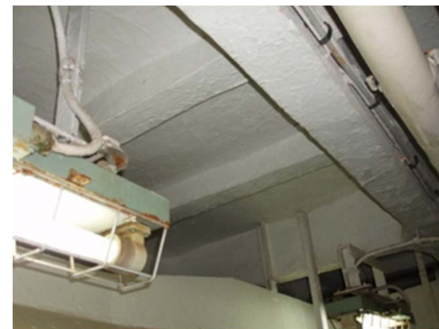
天井に吹き付けられた結露防止アスベスト材
