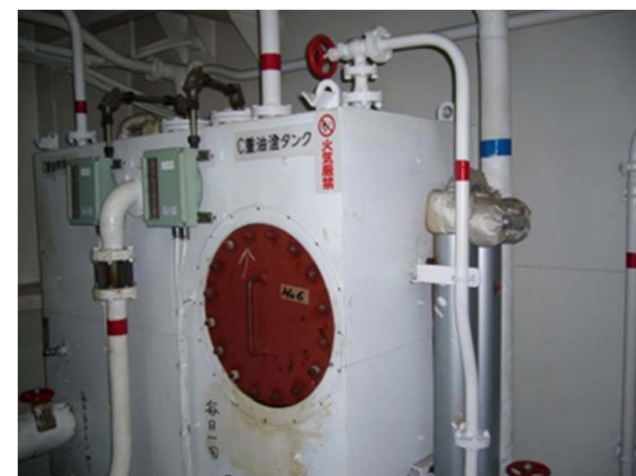
タンクの保温板。保温板をブリキ板で補強したもの
