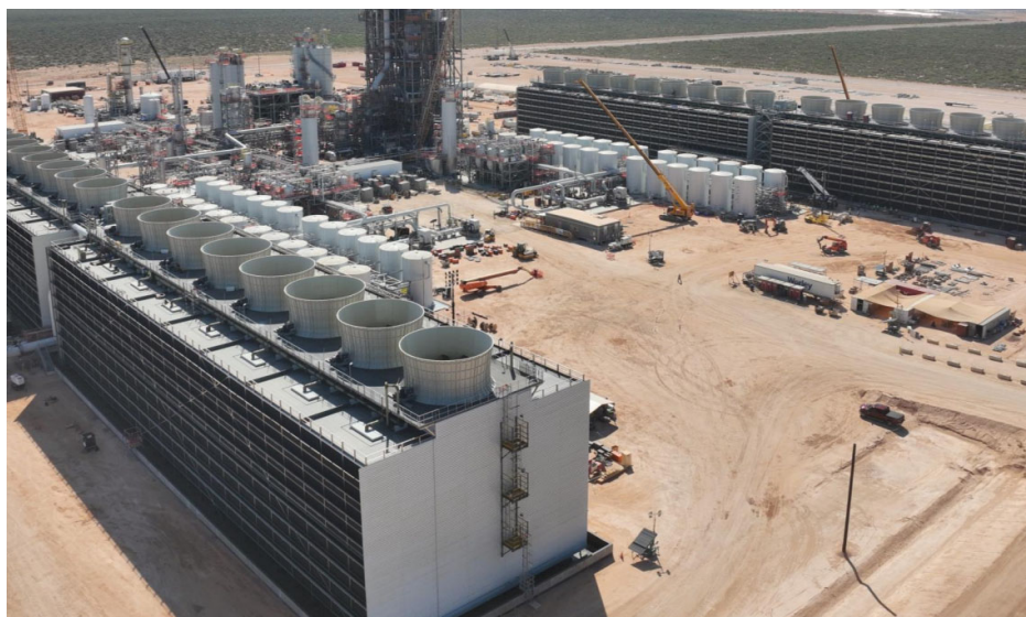
図 17 テキサス州で建設中の 1PointFive ストラトス DAC プロジェクト
