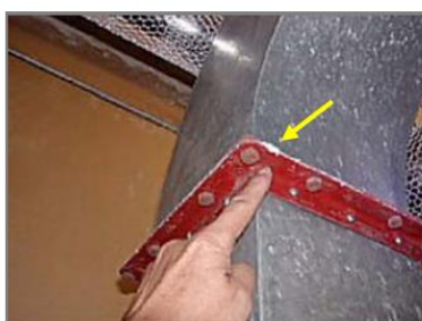
空調ダクトパッキング （ダクトの間に挟まっている白いもの）
