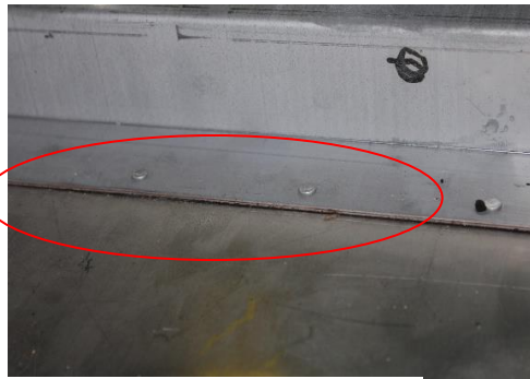
HEPA フィルタ取り付け面
