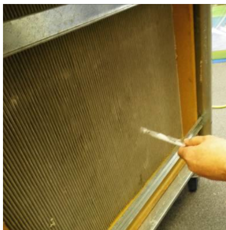
参考図3.24 HEPAフィルター面
