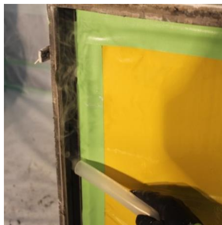
参考図3.25 HEPAフィルター周辺部分
