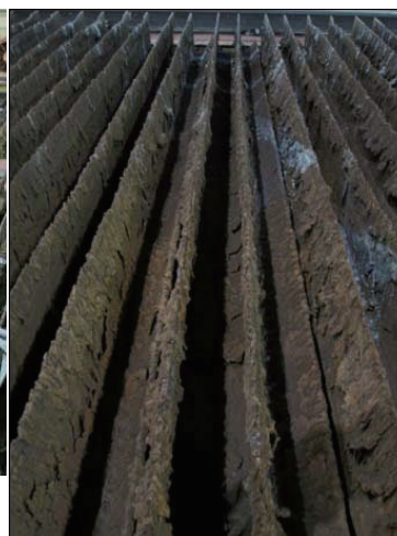
スラット板の反り返り
