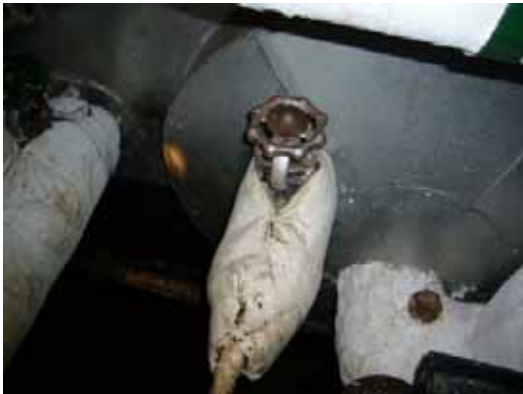
(蒸気弁に使用のアスベスト布団)
