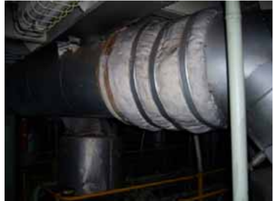
(排気管エキスパンション部アスベスト布団)
